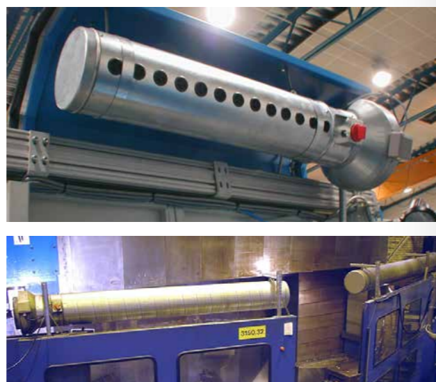
Řízené proudění vzduchu pomocí vzduchových clon
